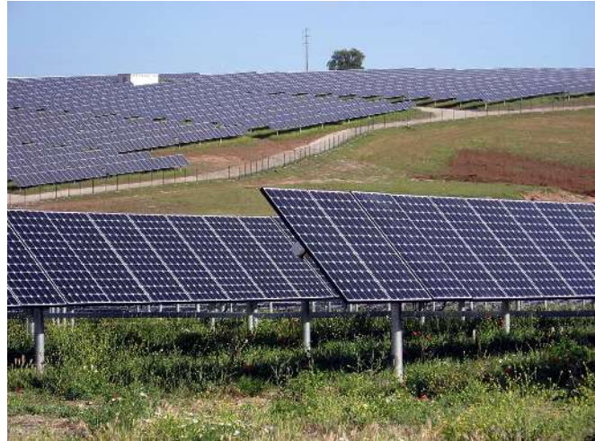
Freiflächen-Photovoltaikanlagen (Serpa, Portugal). Lizenz: Ceinturion, CC BY 3.0 , via Wikimedia Commons
