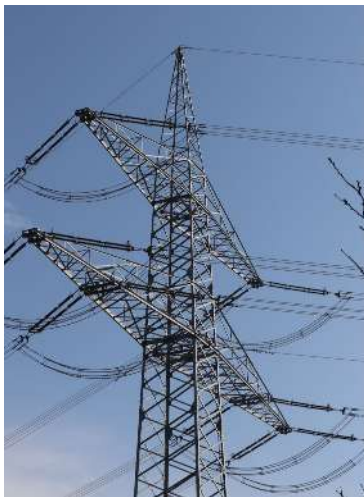
Abbildung 3: Freileitungsmast, sogenannter Donaumast
